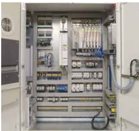
Schaltschrank mit Kühlaggregat fest an der Maschine angeordnet
